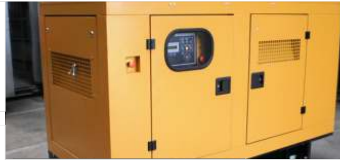
DAİRE İÇİ ELEKTRİĞİ KARŞILIYAN JENERATÖR
